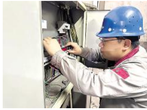
东城能源电工 岳进 他勤奋好学，掌握了扎实的设备知识，在此基础上，完善了相关技术标准，并热心对班组成员传帮带。他细心巡查，以高度的责任感，出色完成了电线线路标准化整改，消除了安全隐患，为实现全年零事故发挥了重要作用。
